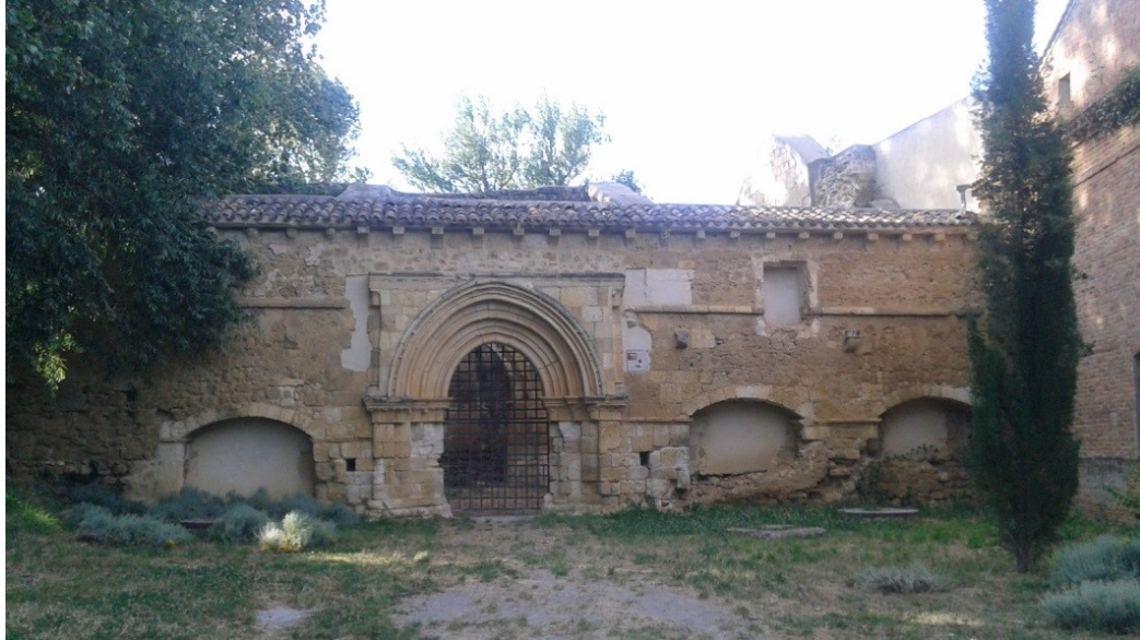
Monasterio de San Salvador, Nogal de las Huertas (Palencia), muro sur de la iglesia.
